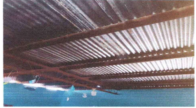
Foto 2: Se Observa deterioro en las Costaneras del modulo No. 1
